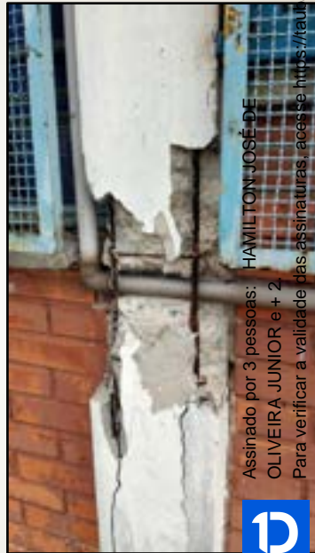
Alvenaria danificada, 2022 Rio Grande da Serra – SP; Acervo REGEA
