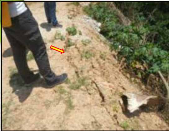
Trinca no talude Lindóia – SP Acervo REGEA
