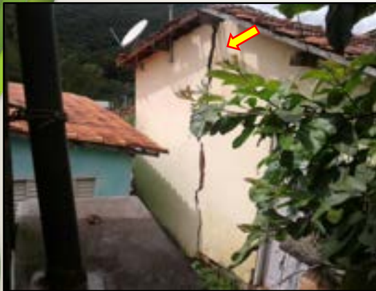
Trinca na casa, 2022 Cunha – SP Acervo REGEA
