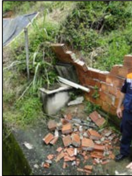
deslizamento com muro danificado, 2018 Bananal – SP; Acervo REGEA
