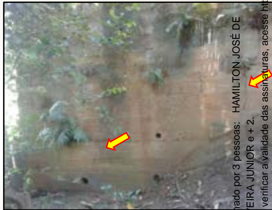
Trinca no muro, 2022 São José do Barreiro – SP Acervo REGEA
