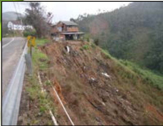
Cicatriz de deslizamento, 2015 Nova Friburgo – RJ Acervo JICA
