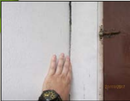
Trinca na casa, 2017 Rio Grande da Serra – SP Acervo REGEA
