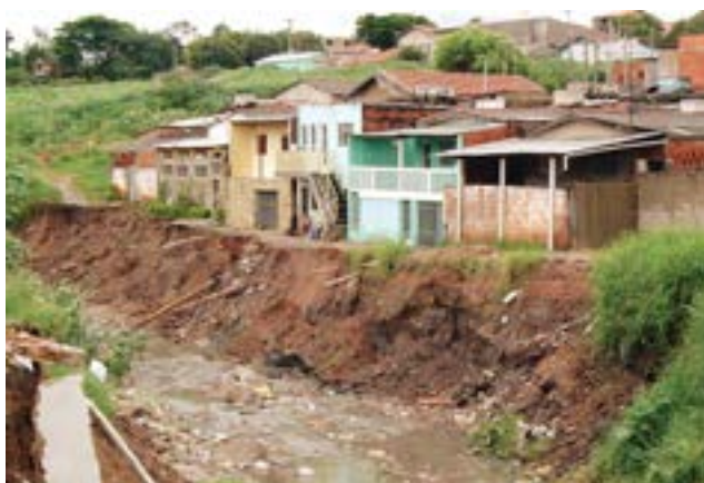
Figura 5.8 – Situação de risco associada a erosão e solapamento dos taludes marginais, com ocupação ribeirinha.
