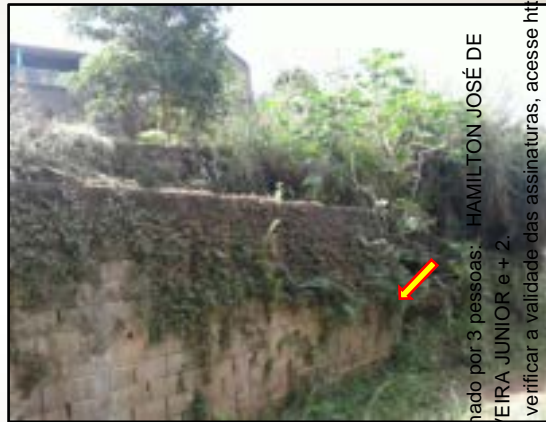
Muro embarrigado e com vegetação indicando umidade Lagoinha - SP Acervo REGEA
