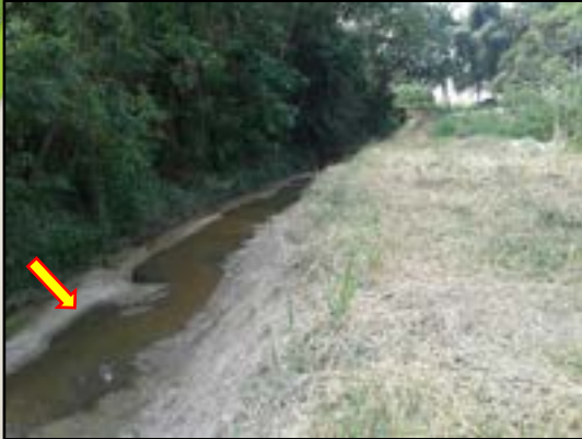
Drenagem com processo de assoreamento, 2022 Jacarei – SP Acervo REGEA
