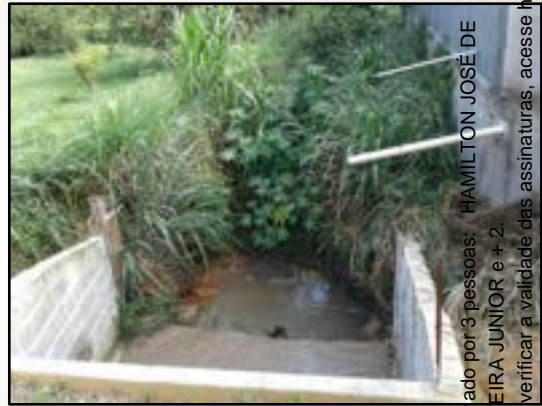
Lançamento irregular de água servida em corpo hídrico, 2022 Cruzeiro – SP Acervo REGEA
