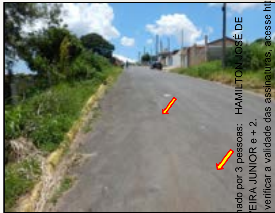
Trincas na via, 2022 Lindóia – SP Acervo REGEA
