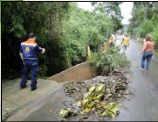
Solapamento afetando a via e cabeceira de ponte, 2018 Bananal – SP Acervo REGEA
