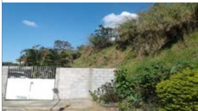
Foto: 1652797756222.jpg ID: 14 Evidência de movimentação no terreno, Formação de processo erosivo, Moradia sujeita a risco de escorregamento, Presença de árvore inclinada
