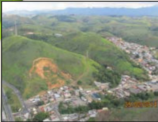
Cicatriz de deslizamento circular com degraus de abatimento, 2014
