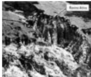
(a) Detalhe da erosão
