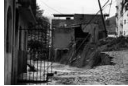
Foto 7.5: Taludes marginais que sofreram solapamento
