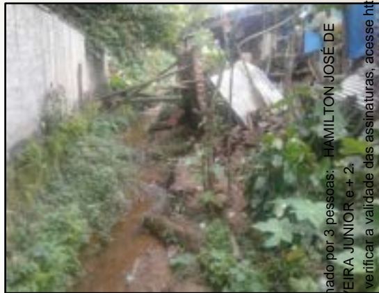
Muro e residência afetados pelo solapamento, 2022 Bananal - SP Acervo REGEA
