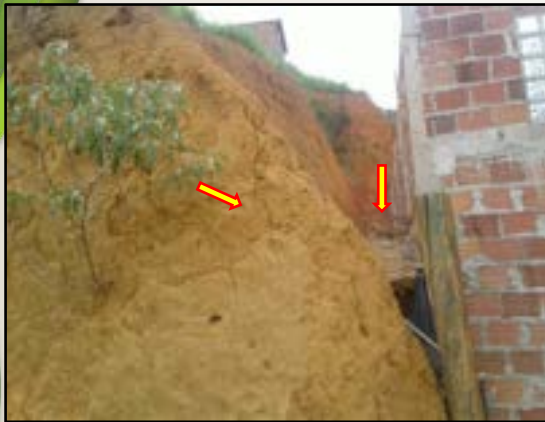
Moradia encostada no talude, que contém trincas, 2022 Cruzeiro – SP Acervo REGEA
