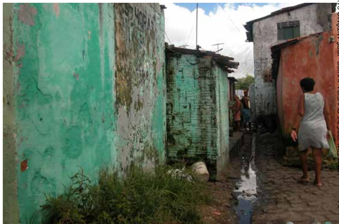
Precariedade da infraestrutura básica; esgoto corre pela viela de pedestres (Maruim/RN)
