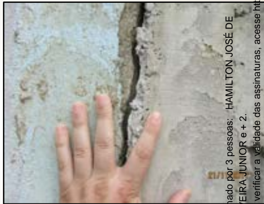
Trinca de maior espessura, 2017 Rio Grande da Serra – SP Acervo REGEA
