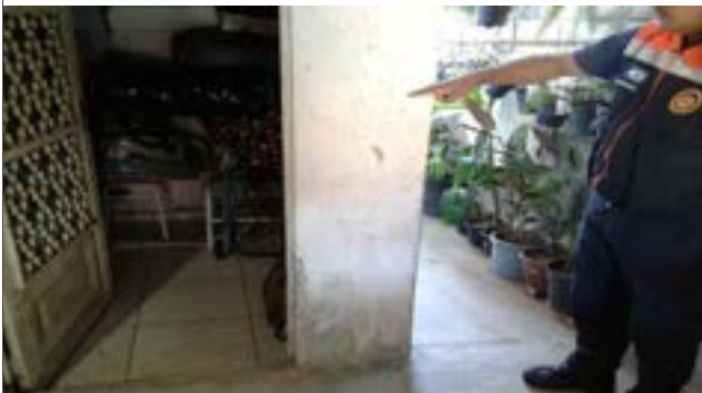
Foto: 1652813618457.jpg ID: 13 Detalhe para marca de água
