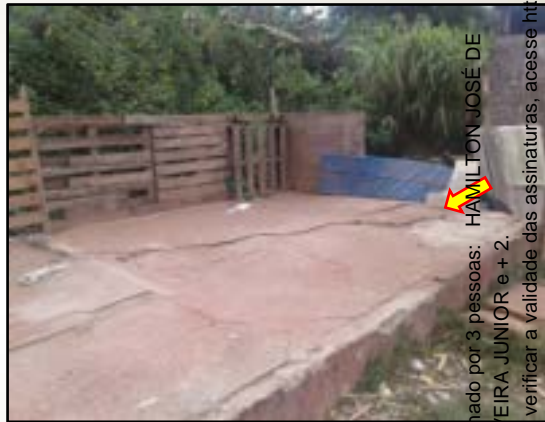
Trinca no pavimento, 2022 Tremembé - SP Acervo REGEA
