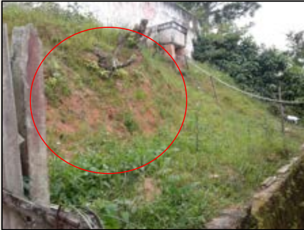
Erosão laminar em talude, 2022 Bananal - SP Acervo REGEA
