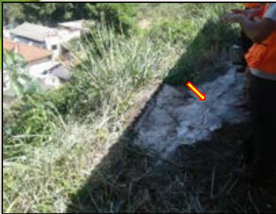
Trincas no terreno, 2022 Queluz – SP Acervo REGEA
