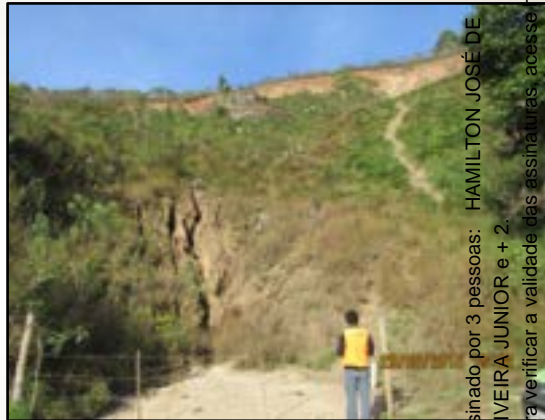
Ravina em talude, 2015 Nova Friburgo – RJ Acervo JICA
