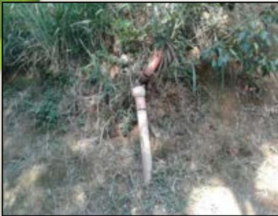
Encanamento danificado, 2022 Queluz – SP Acervo REGEA
