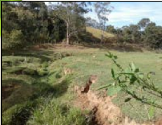
Sulco erosivo em talude marginal, 2022 Redenção da Serra – SP Acervo REGEA
