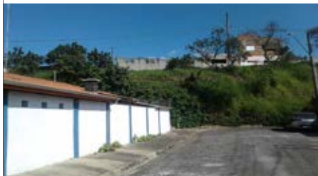
Foto: 1652797386490.jpg ID: 12 Visão geral do setor, Depósito de escorregamento pretérito, Evidência de movimentação no terreno, Formação de processo erosivo, Moradia sujeita a risco de escorregamento, Presença de cicatriz de escorregamento pretérito, Talude de corte com solo exposto
