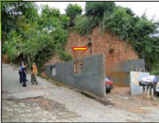
Trinca no talude, 2018 Bananal – SP Acervo REGEA
