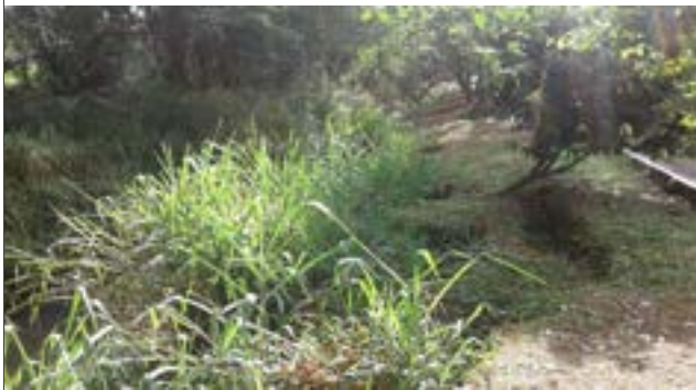
Foto: 1652722885684.jpg ID: 23 Presença de cicatriz de escorregamento pretérito, Evidência de movimentação no terreno, Formação de processo erosivo
