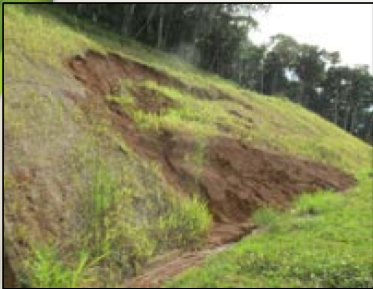
Cicatriz de deslizamento planar, 2015 Antonina – PR Acervo JICA
