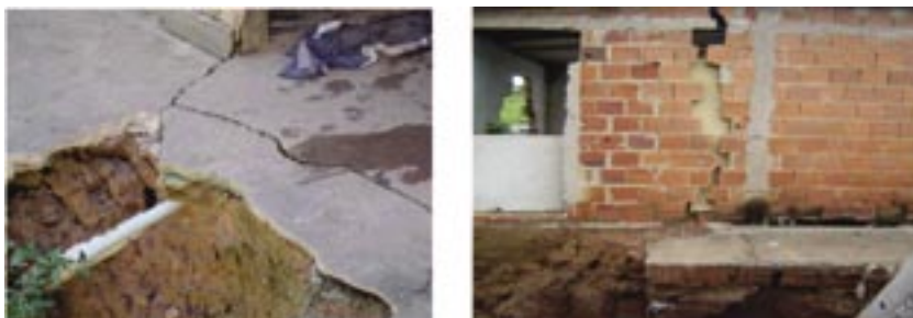
FIGURA 10. A) PRESENÇA DE TRINCAS NO PISO DE MORADIA. B) MORADIA COM PAREDES TRINCADAS EM RAZÃO DE INSTABILIDADE DO TERRENO.
