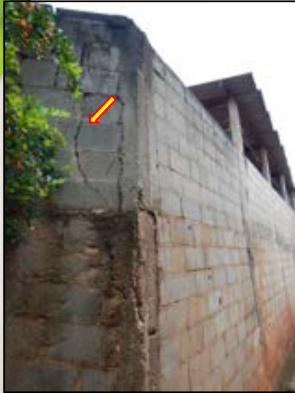
Muro com trinca Monteiro Lobato – SP; Acervo REGEA
