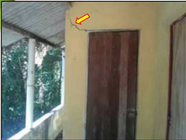
Trinca na casa, 2022 Areias – SP Acervo REGEA
