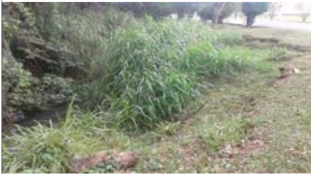
Foto: 1652722723855.jpg ID: 22 Detalhe do canal, Presença de cicatriz de escorregamento pretérito, Evidência de movimentação no terreno, Formação de processo erosivo
