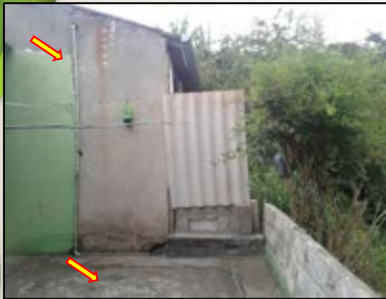
Trinca na casa e pavimento, 2022 Areias – SP Acervo REGEA
