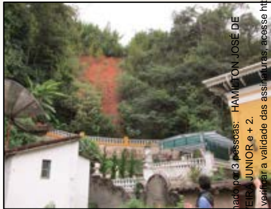
Cicatriz de deslizamento planar, 2015 Petrópolis - RJ Acervo JICA
