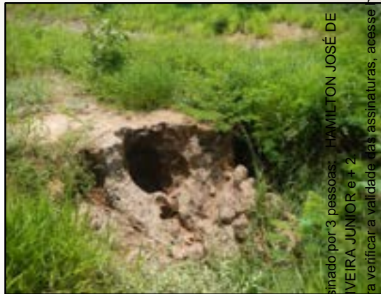
Processo erosivo Casa Branca – SP Acervo REGEA
