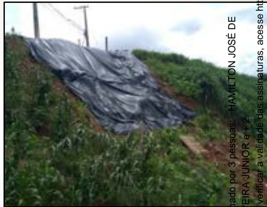
Cicatrizes de deslizamento com lona, 2022 Franco da Rocha – SP Acervo REGEA
