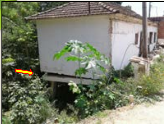
Casa de alvenaria comprometida, 2022
