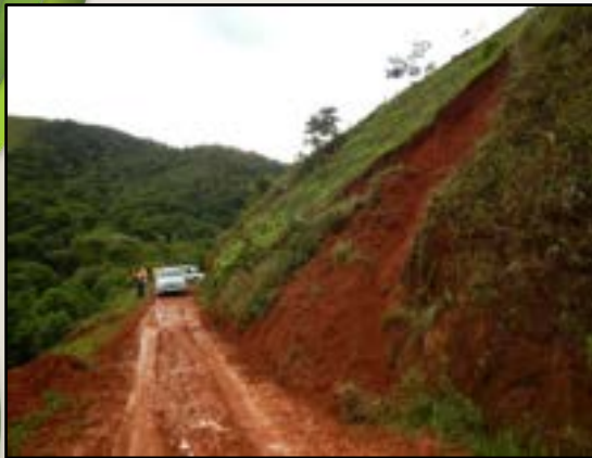
Cicatriz e depósito de deslizamento, 2014 Monteiro Lobato – SP Acervo REGEA
