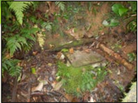
Caixas e tubulação em estado precário, 2015 Petrópolis – RJ Acervo JICA
