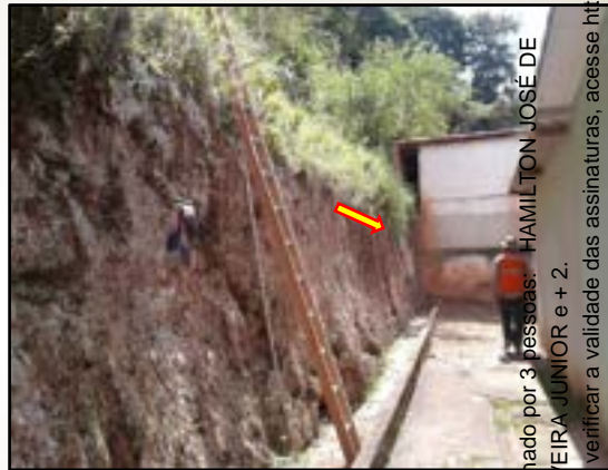
Moradia com distância do talude e moradia encostada ao talude, 2022 Paraibuna – SP Acervo REGEA
