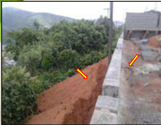
Trincas no talude e na laje, 2022 Paraibuna – SP Acervo REGEA
