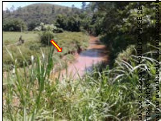
Drenagem com processo de solapamento, 2022 Acervo REGEA
