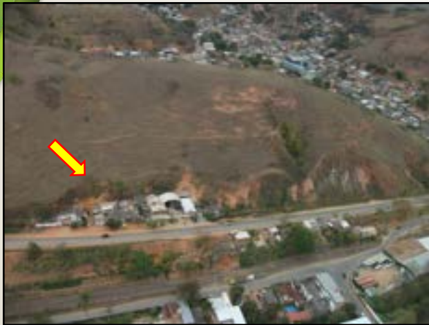
Trincas na encosta Acervo REGEA
