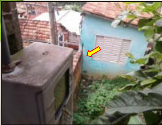
Trinca na casa, 2022 Cunha – SP Acervo REGEA
