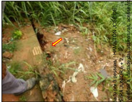
Trinca no talude, 2018 Bananal – SP Acervo REGEA
