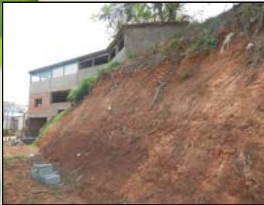
Talude com solo exposto Socorro – SP Acervo REGEA
