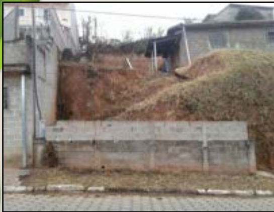
Talude de corte, notar presença de umidade, 2022 Natividade da Serra - SP Acervo REGEA
