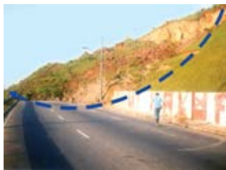
Figura 3.9 – Deslizamento circular ou rotacional.
