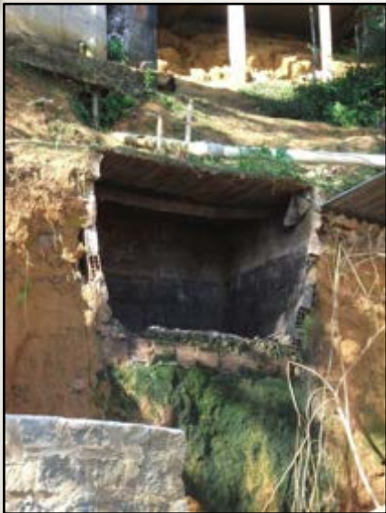
Fossa rompida em talude, 2010 Paraty – RJ Acervo REGEA
