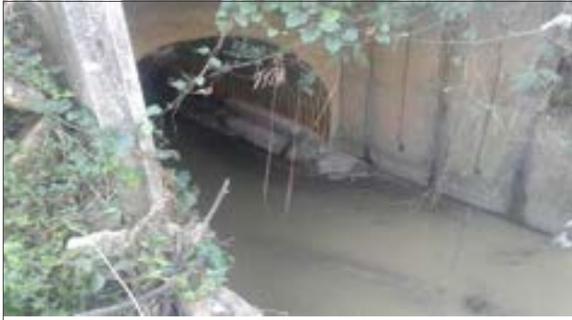
Foto: 1652894965921.jpg ID: 11 Detalhe do canal
