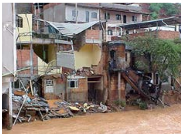
Figura 5.12 – Situações de risco associado a enchentes com alta energia de escoamento.
