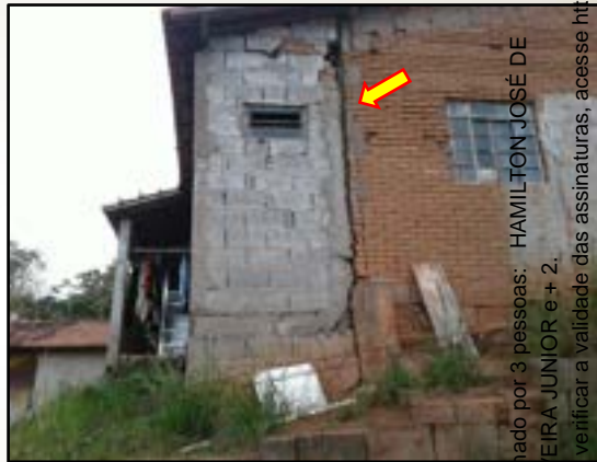
Trinca na casa, 2022 Redenção da Serra – SP Acervo REGEA
