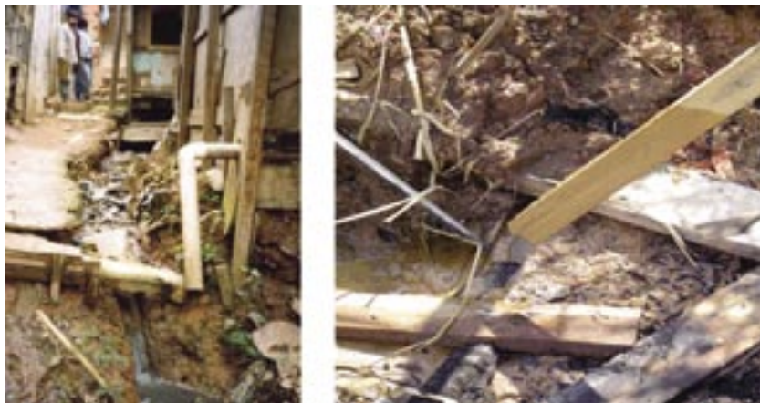
FIGURA 12. A) LANÇAMENTO DE ÁGUA E DE ESGOTO NA SUPERFÍCIE DO TERRENO. B) SURGÊNCIA DE ÁGUA NO TALUDE.
