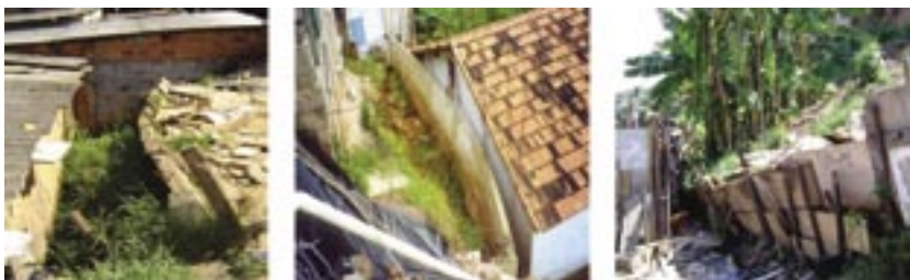
FIGURA 11. MUROS ENCURVADOS, INDICATIVO DA IMINÊNCIA DE RUPTURA.
