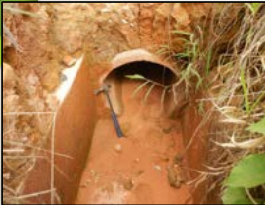
Tubulação obstruída por sedimento Cotia – SP Acervo REGEA
