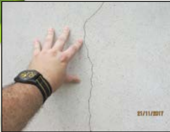
Trinca de pequena espessura, 2017 Rio Grande da Serra – SP Acervo REGEA
