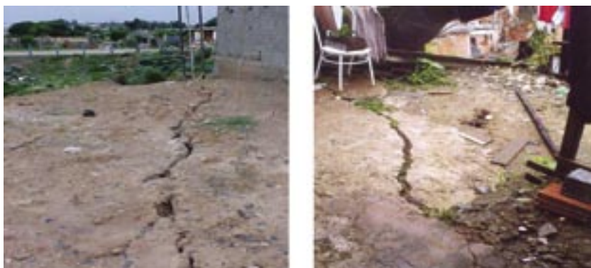
FIGURA 8. FEIÇÃO DE INSTABILIDADE DO TIPO TRINCAS NO SOLO E EM ATERRO.
