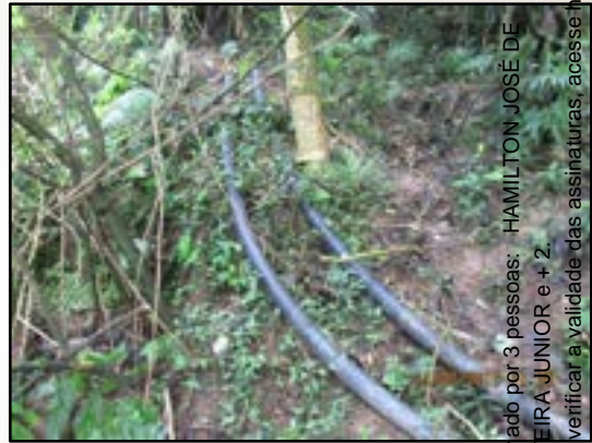
Canos flexíveis para abastecimento de água, 2015 Petrópolis – RJ Acervo JICA
