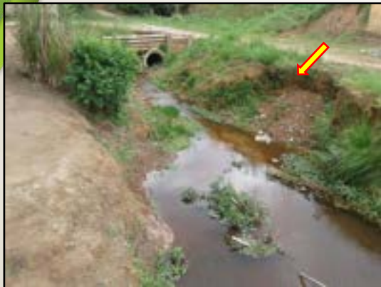
Drenagem com processo erosivo e de solapamento, 2022 Acervo REGEA
