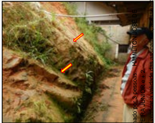
Rocha com plano favorável ao deslizamento, 2015 Blumenau – SC Acervo JICA
