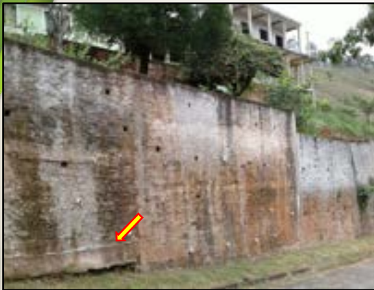
Muro danificado, 2022 Arapeí - SP Acervo REGEA
