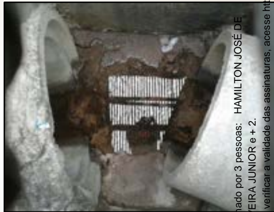
Tubulação com manutenção deficiente, 2022 Lorena – SP Acervo REGEA
