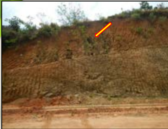
Sulcos erosivos Socorro – SP Acervo REGEA
