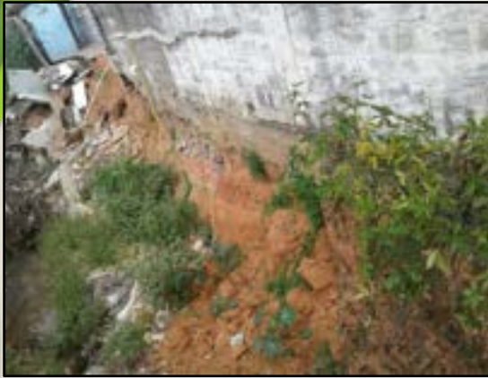
Edificação destruída por solapamento, 2022 Guaratinguetá – SP Acervo REGEA
