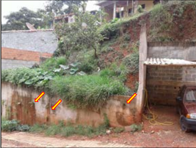
Muro com umidade, 2020 Igaratá - SP Acervo REGEA
